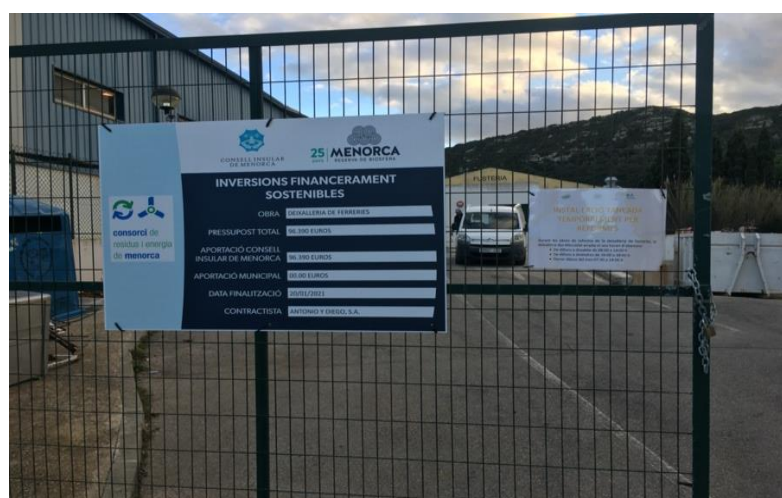
Figura 56.- Punt verd de Ferreries (en obras).
